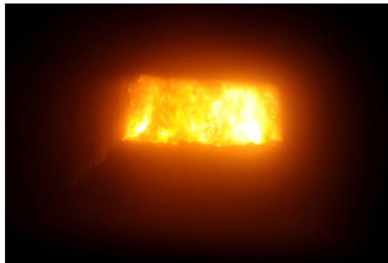
Det flisfyrede anlæg på Vestermark er taget i brug og leverer i øjeblikket energi til fjernvarmeforbrugerne, der får varmen fra tonsvis af træflis fortrinsvist leveret af Naturstyrelsen.
